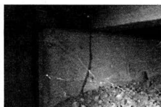
シロアリが侵入してできる蟻道
