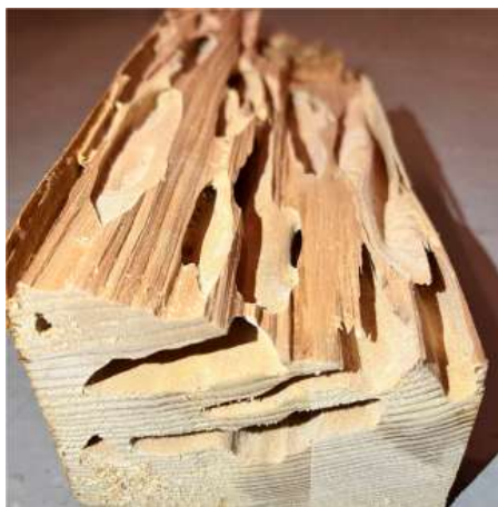
アメリカカンザイシロアリの被害に遭った柱の一部
